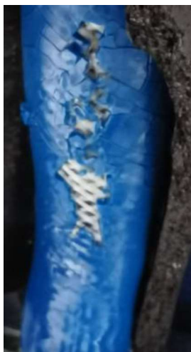
Figure 1 : Tuyau de vidange dégradé
