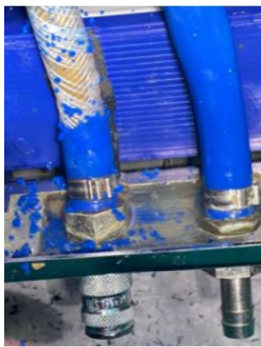
Figure 2 : Tuyau bleu dégradé vs. tuyau bleu intact
