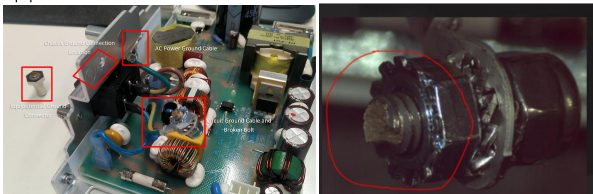
Figure 1 : Châssis et circuit d'alimentation avec fils de mise à la terre débranchés et boulon de mise à la terre cassé
