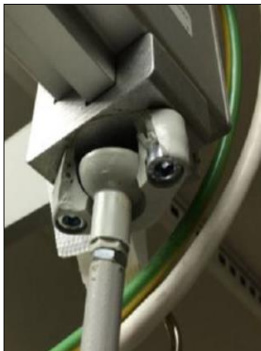
Boîtier de palier en plastique cassé
