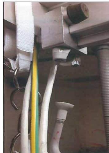
Boîtier de palier en plastique cassé Cela peut entraîner la chute du flexible de câble
