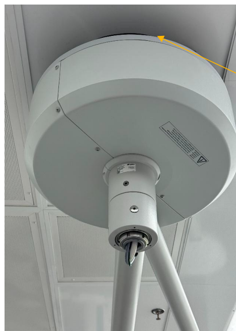
Figure 2: : Exemple de cache plafond non affleurant au plafond
